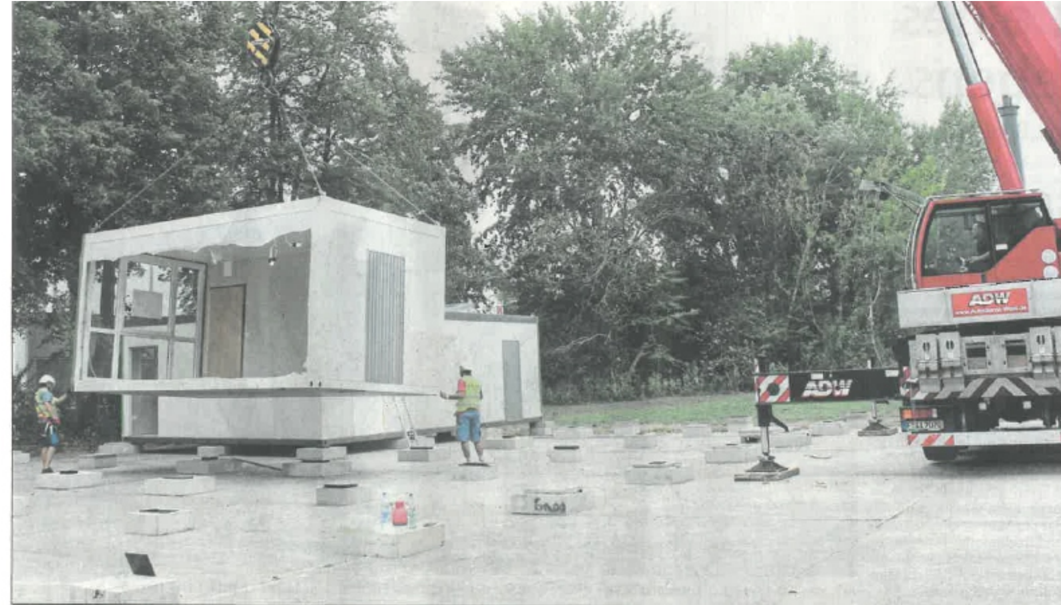
Mithilfe eines Autokrans werden die einzelnen Elemente auf den vorbereiteten Fundamentblöcken platziert. Dabei ist Maßarbeit gefordert. • Foto: Holzamer
